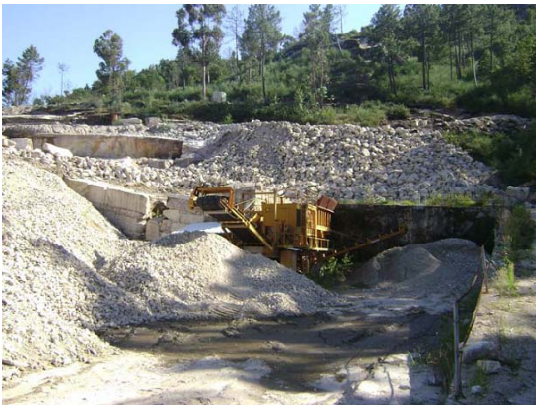
Fotografia 2: Instalação de Britagem
